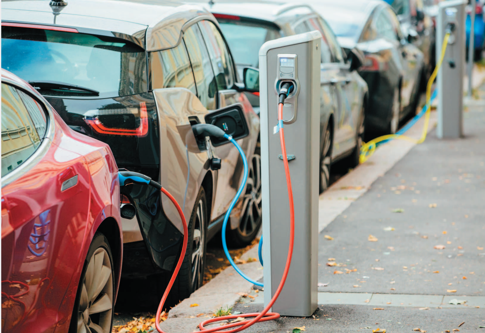
▲ Obr. 1 Nabíjecí stojany budeme na ulicích vidět stále častěji (zdroj: Adobe Stock)
